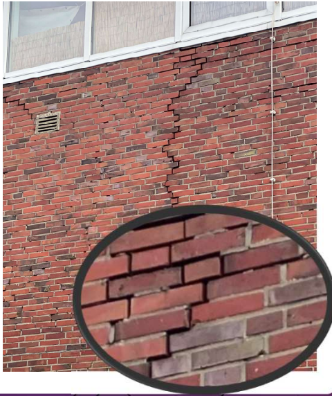
Risse in der Fassade im 2-Schaligen Mauerwerk
