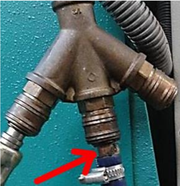
Schlauchverbindung, ölhaltige Schmutzablagerungen sind oftmals ein Indiz für eine Leckage
